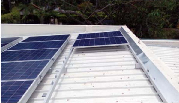
Figura 6. Estructura en aluminio para soportar paneles solares Fuente: El Autor
