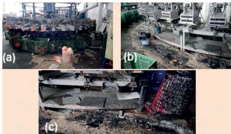
Figura 9. Orden y Aseo: (a) maquina inyectora de plantillas – Poliuretano derramado en el suelo y en recipientes plásticos sin tapar, (b) maquina inyectora de suelas – Poliuretano derramado en el suelo y en recipientes plásticos sin tapar y (c) maquina inyectora de suelas – Poliuretano derramado en el suelo y sobre cartón contaminando desechos reciclables.
