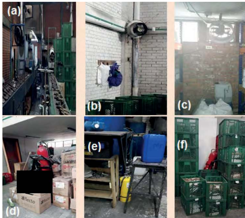
Figura 6. Extractores de Vapores y Extintores: (a) Extractores cabinas de Pintura, (b) Extractor bodega 1, (c) Extractor almacén, (d) Extintor bodega 3 con los depósitos de basura, (e) Extintor bodega 2 al lado de las cabinas de pintura y (f) Extintor bodega 3 con los depósitos de basura.
