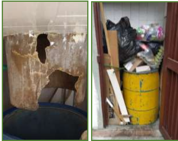
Imagen 4 y 5. Mal estado de los ductos y disposición inadecuada de los residuos (Espitia et al, 2020)
